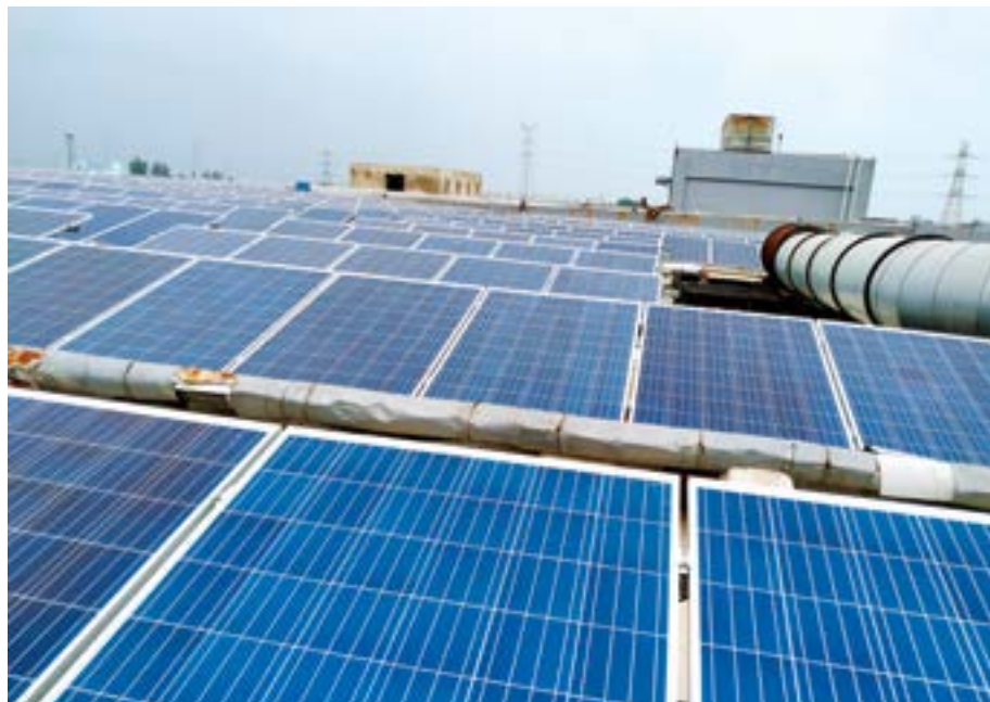
【扬子石化】在帮扶贫困村建设分布式光伏发电项目
