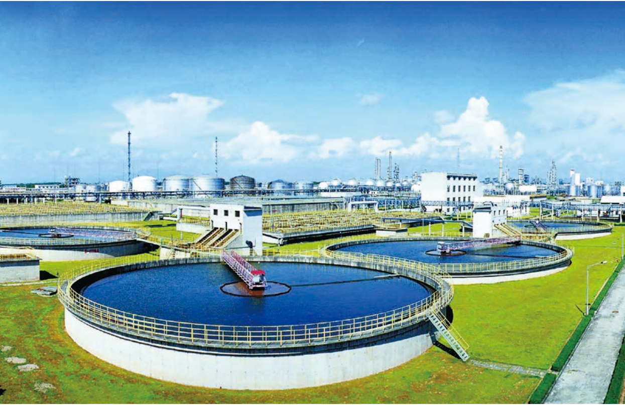
中国石化茂名石化乙烯污水处理装置
