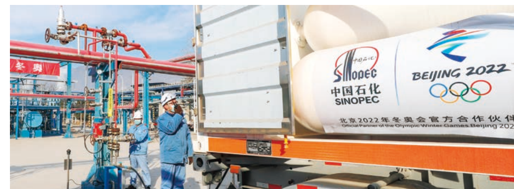
中国石化燕山石化北京冬奥会氢气新能源保供项目
